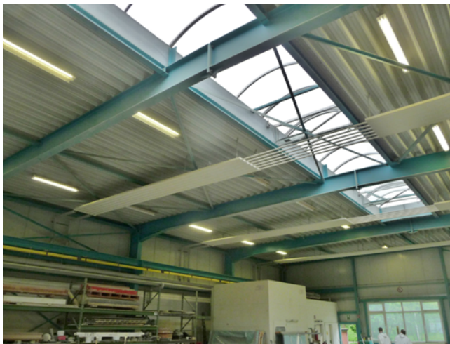
Abb. 17 Abgehängte Lichtbänder mit Tageslichtanteil
